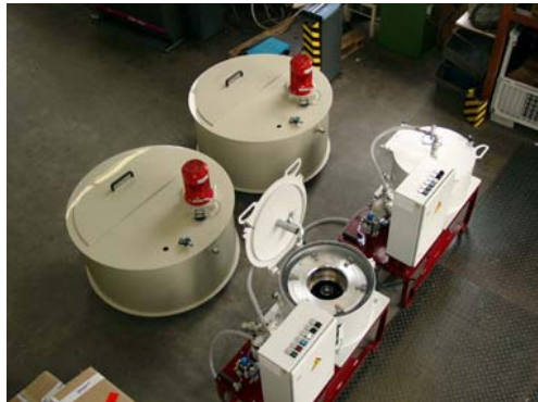
U-15 Zentrifugen-Anlage mit Abwasserbehälter
