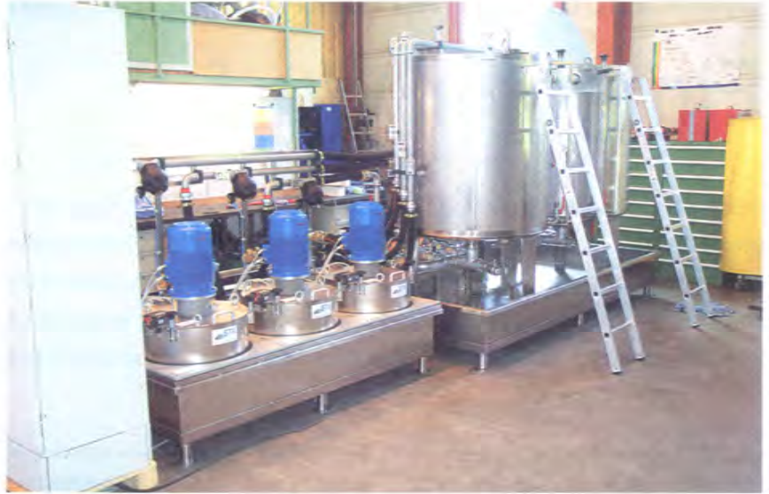
Bei Airbus in Bremen kommen drei Zentrifugen vom Typ S-15 zum Einsatz (im Vordergrund links). Das Wasser fließt dabei aus dem Schmutztank (großer Stahlbehälter rechts) durch die Reinigungsanlage in den Reintank (linker Stahlbehälter).
