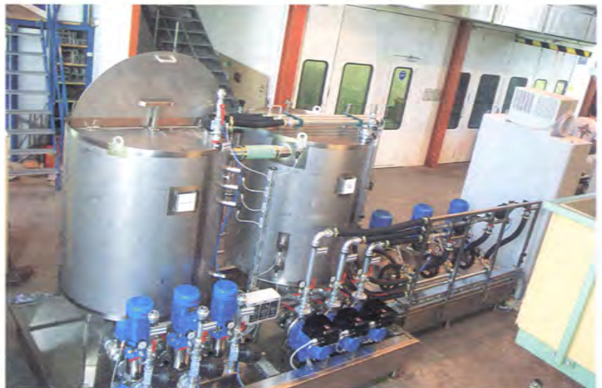
Frequenzgeregelte Beschickungspumpen (blaue Elektromotoren mit schwarzem Aufbau, Bildmitte) stimmen den Zufluss in die drei Zentrifugen bedarfsgerecht aufeinander ab
